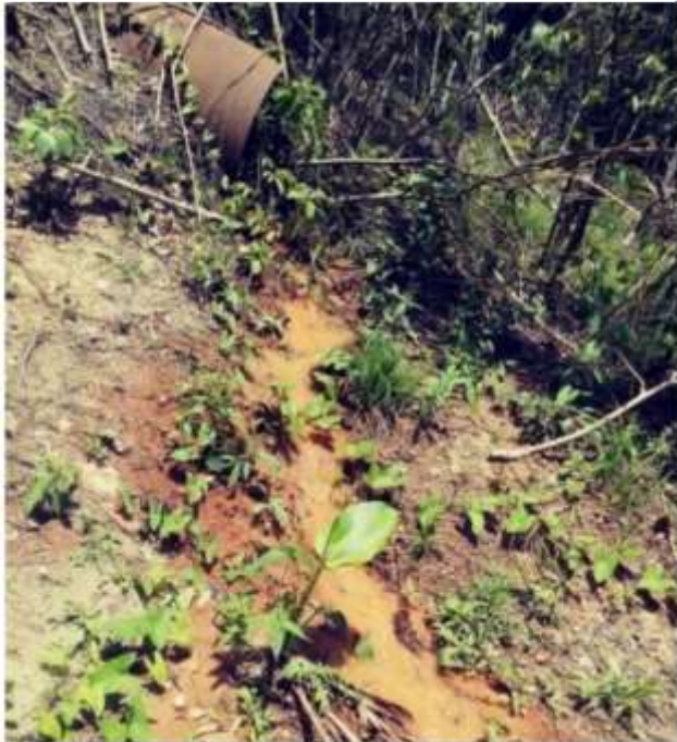
Figura 03- Duto clandestino onde material tóxico era despejado
