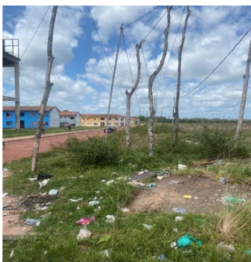
Figura 28 - Carandirú- Instalação elétrica informal.
