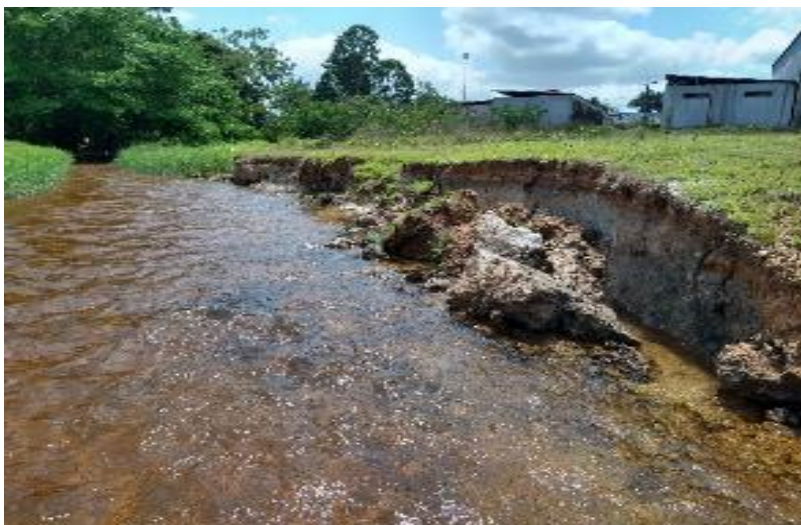
Figura 47 – Prédios e solo exposto com erosão na confluência do igarapé Garrafão com o rio Jipuúba, no bairro Centro
