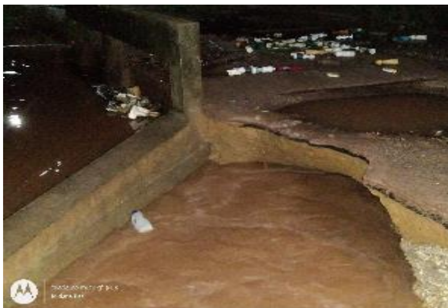
Figura 33 – Lixo depositado no leito, margens e sobre a ponte do igarapé Garrafão, no bairro Bela Vista, após chuva moderada
