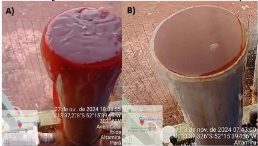
Figura 7: Retrolavagem do filtro no final e no início das carreiras de filtração
